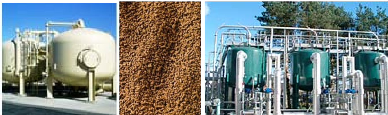
Postrojenje i pilot postrojenje za tretman vode za piće sa reaktorom sa nepokretnim slojem granulisanog medija Bayoxide E33
